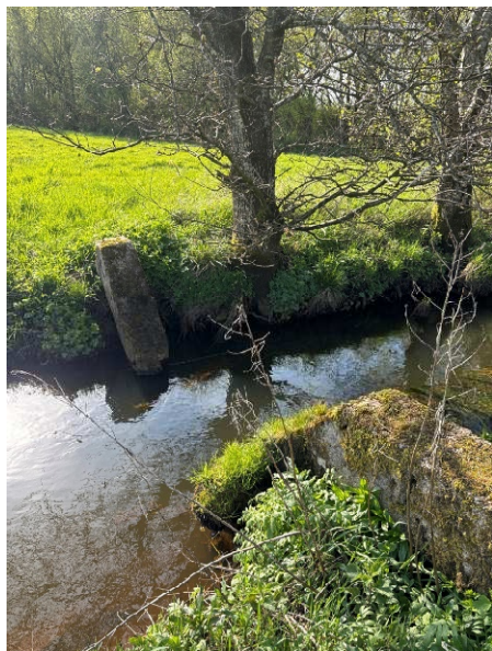
Figur 3-12 Betonstyr i Skibbild Bæk i st. 140 m.
